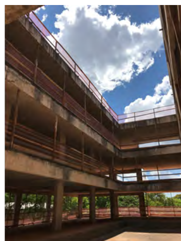
19 – Proteções guarda corpo internas
